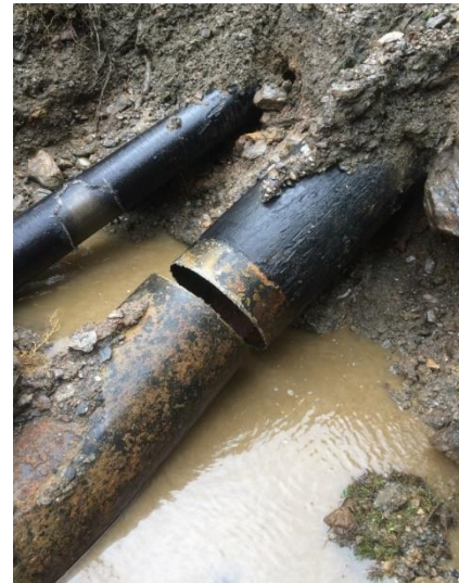
Photo de la casse d'une conduite forcée suite glissement de terrain.
