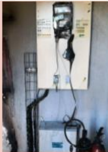
Domages sur armoire électrique
