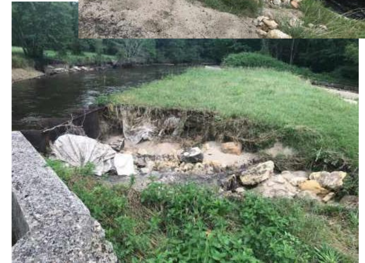
Détériorations des abords de la passe à poissons remontée canal de décharge
