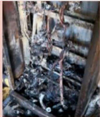
Incendie sur batteries de condensateurs
