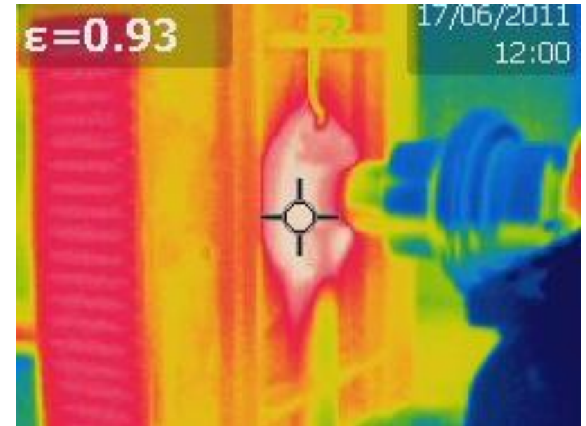
Thermographie palier alternateur et accouplement
