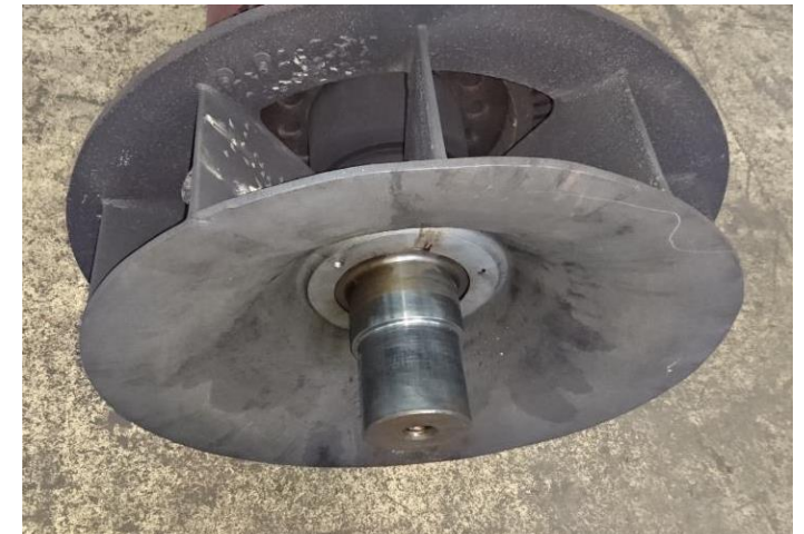
Vestiges d'un nid d'insectes sur le ventilateur
