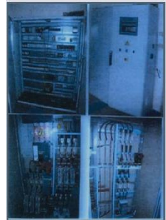
Vue d'une armoire BT avec batteries de condensateurs
